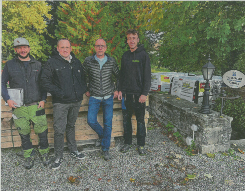
Stemmen in Rekordzeit den Umbau des Heinsheimer Schlossrestaurants zur Tagespflege (von links): Bauleiter Tim Engelhardt, Diakonie-Geschäftsführer Johannes Klopprogge, Bauherr Manfred Bauer und Zimmermann David Bauer Fotos: Ulrike Plapp-Schirmer
